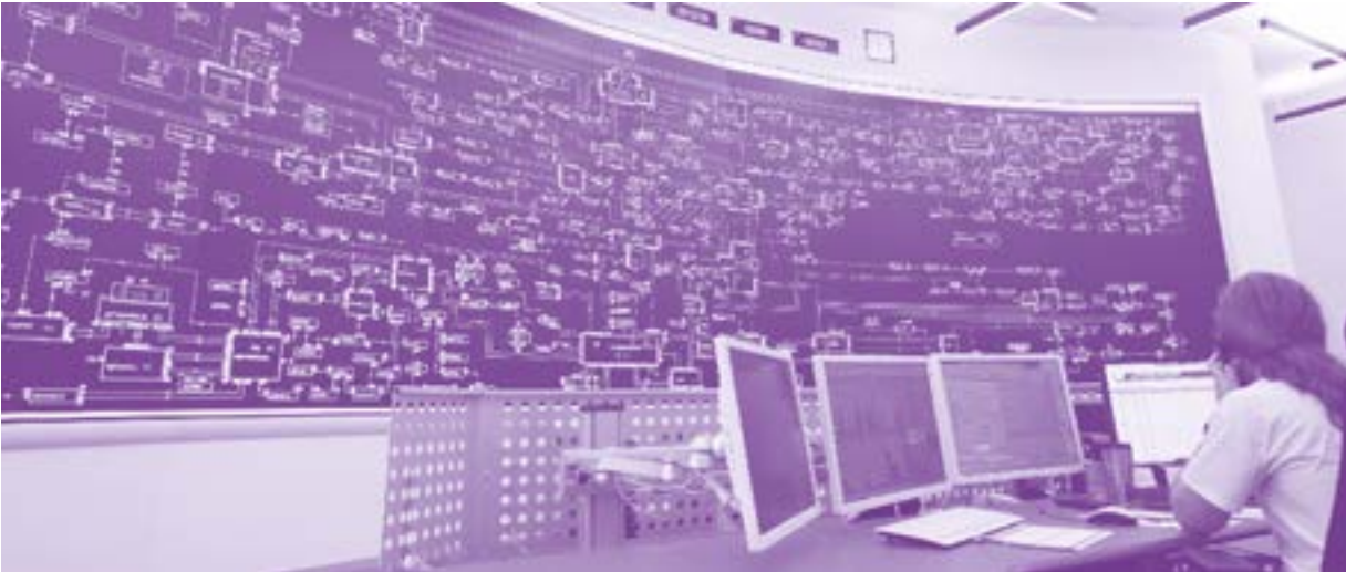
Κέντρο Ελέγχου Ενέργειας Κρουονερίου
